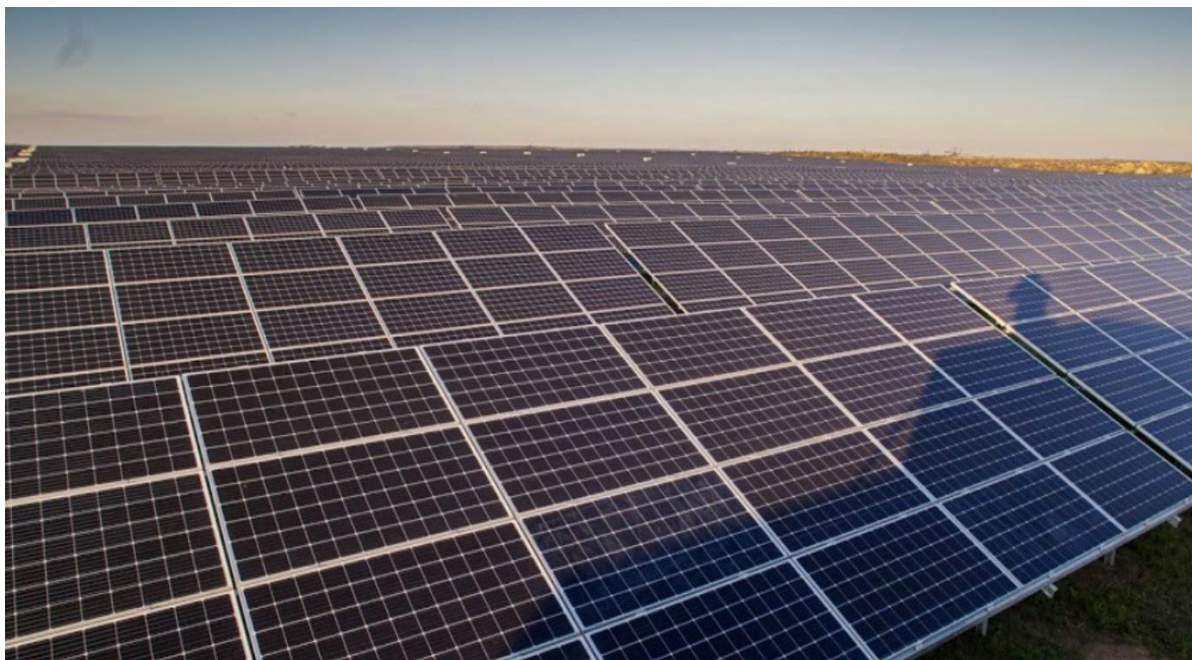
Рис. 1.1. Дніпропетровська сонячна електростанція
