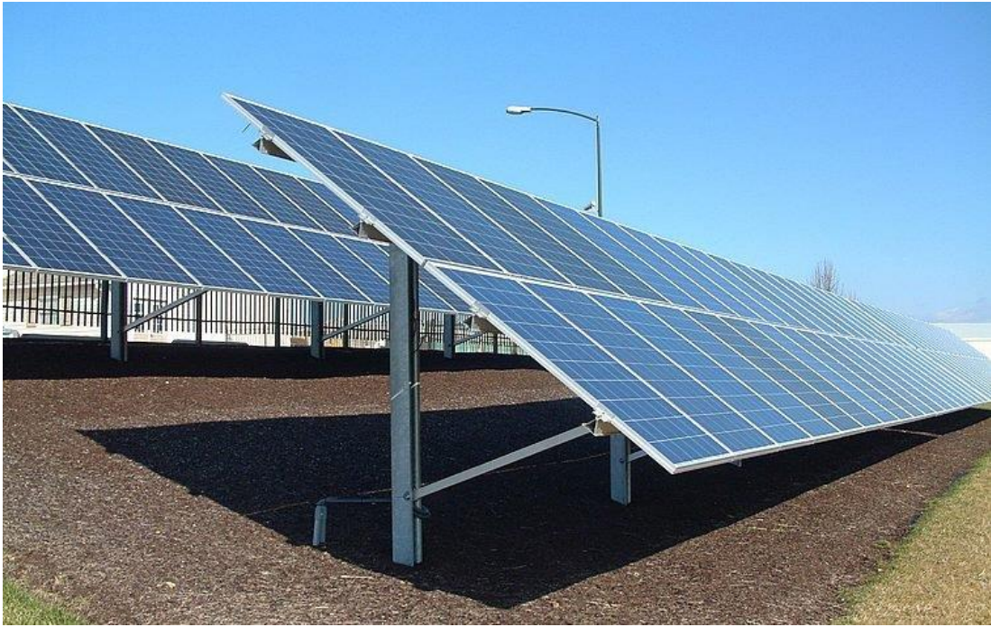
Рис. 1.2. Наземні сонячні електростанції
