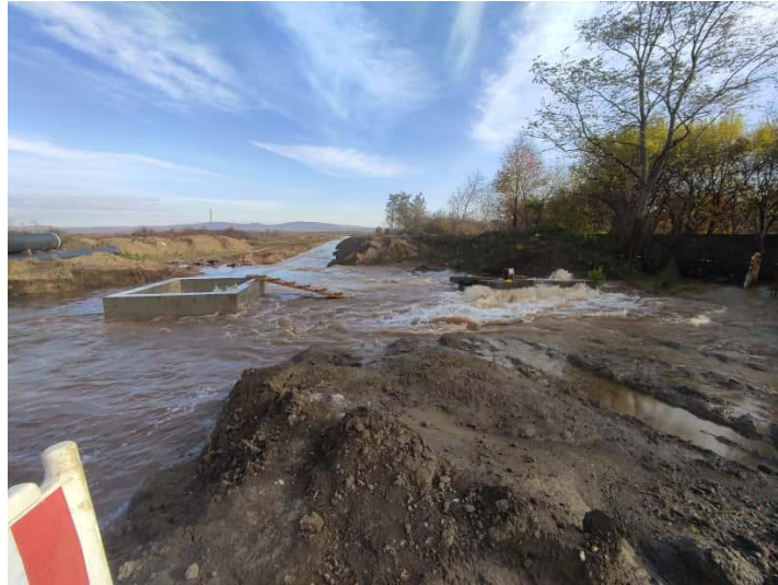
Рис. 3.3.2 Вигляд пошкодженної сусідньої гілки водогону
