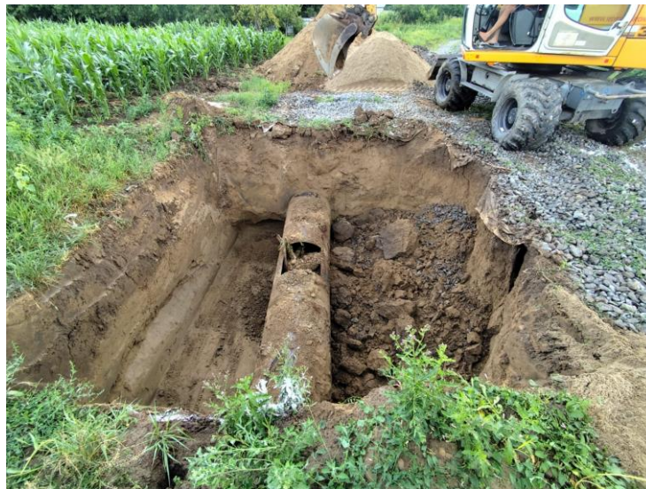
Рис. 2.1.4 Обвал ґрунту після розкриття піщаної основи під глиною
