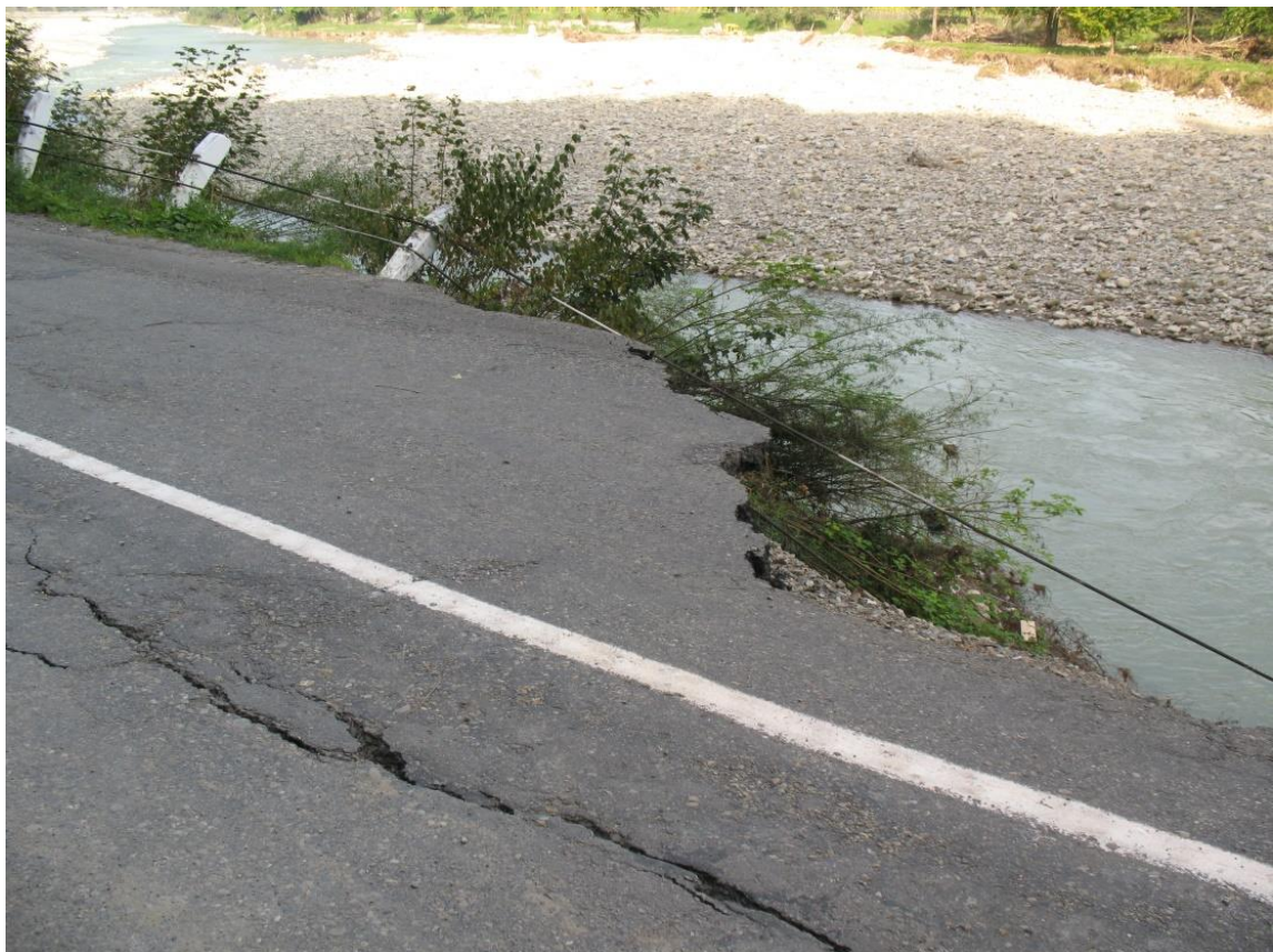
Рис. 2.3. Розмив берега р. Черемош поблизу с. Усть-Путила (2008 р.)
