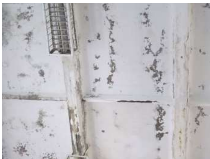
Малюнок 3 – Будівля спортзал середньої загальноосвітньої школи. Руїнування захисного шару бетону ребристих плит перекриття.
