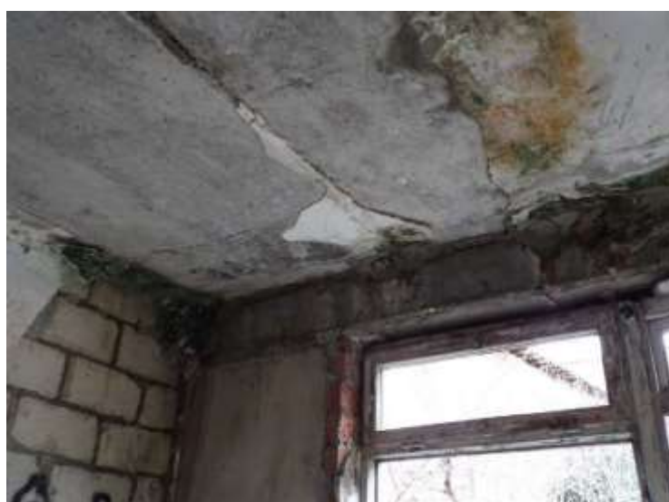
Малюнок 4 – Будівля дитячого садка. Тріщини в багатопустотних конструкціях багатопустотного перекриття, корозія робітників стрижнів і арматурних виробів
