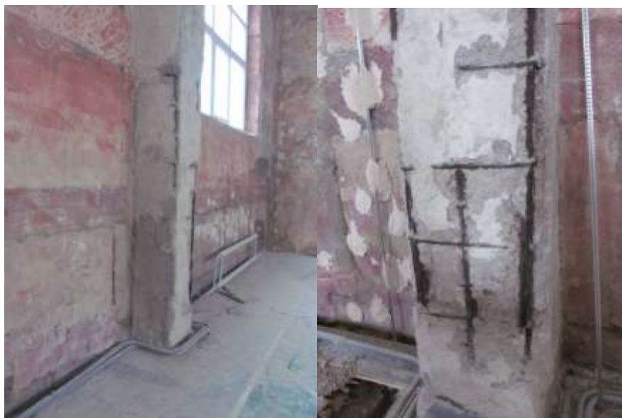
Малюнок 1 – Будівля спортзал середньої загальноосвітній школи. Руїнування захисного шару бетону колони та корозія арматурних робочих стрижнів
