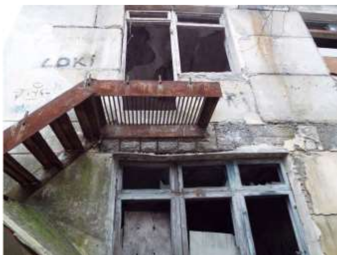
Малюнок 2 – Будівля дитячого саду. Локальне тріщино утворення в несучих стінах, корозія арматурних виробів перемички
