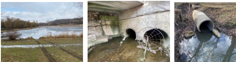
Рис. 1. Фрагменти досліджуваної території парку «Жовтневий»: загальний стан, елементи водовідведення та дощової каналізації. Джерело: фото виконані Семенцовим Данилом.
