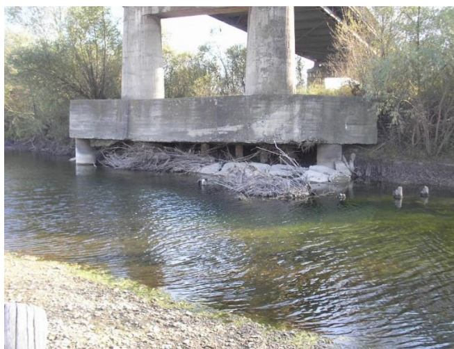
Рисунок 4.6 – Розмив укріплених опор мосту в с. Дубівці після паводку 2008 року
